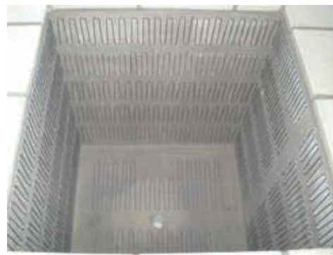
「炉内」 レンガ表面にはアルミナが塗ってあり 釉薬が付着した際に剥し易くしてあります。
